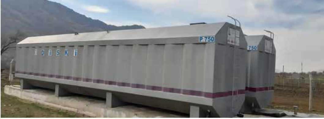
Hani Abacılar Paket Arıtma Tesisi
