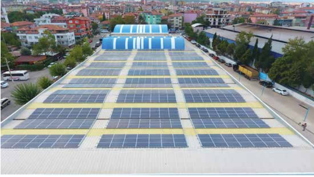
“Gücümüzü Güneşten Alıyoruz” Projesi Çatı Tipi Güneş Panelleri
