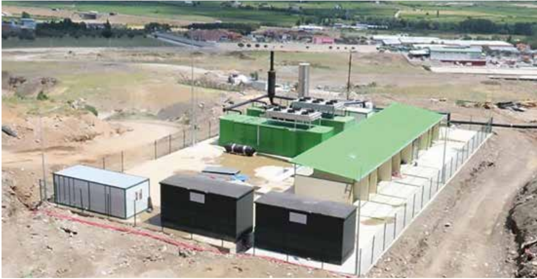
Turgutlu Katı Atık Çöp Depolama Alanı, Elektrik Enerjisi Üretim Tesisi
