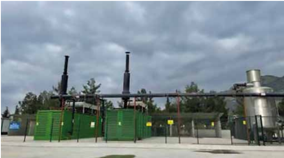
Efeler Katı Atık Düzenli Depolama Sahası Eysel Atıklardan Elektrik Üretimi Tesisi
