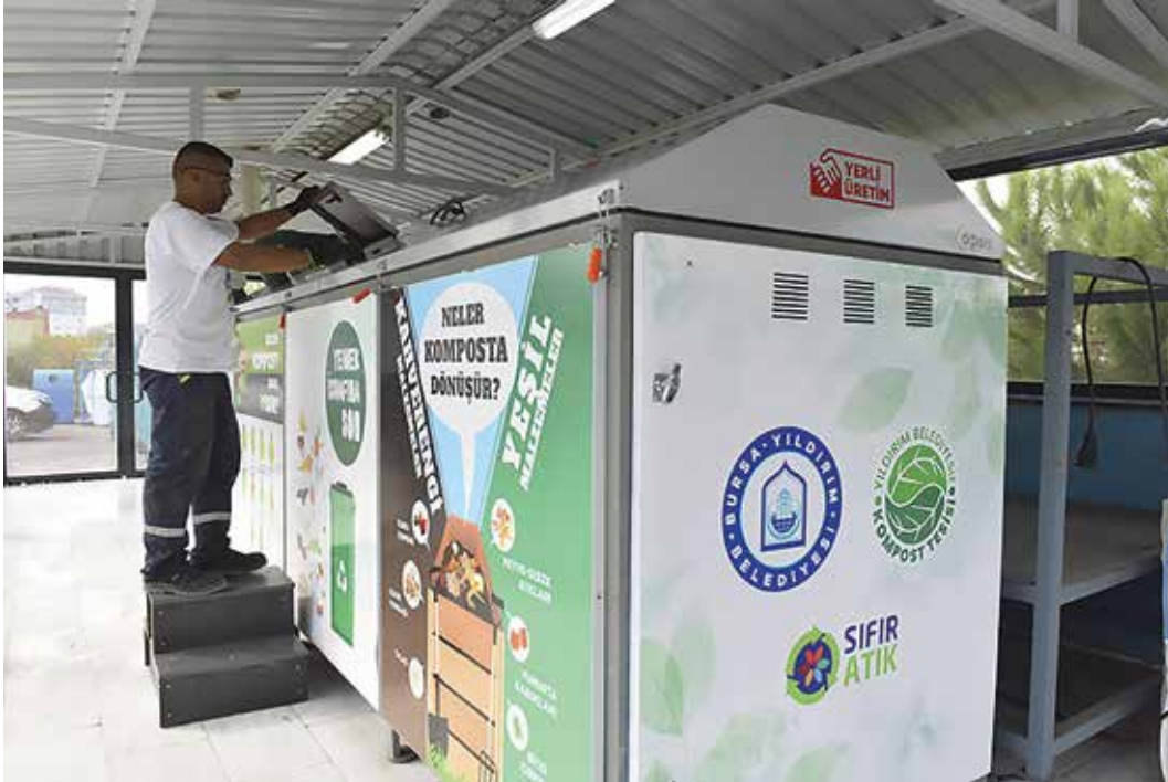
Pazar Atıkları, Organik Gübre Dönüştürme Kompost Tesisi, Yıldırım Belediyesi
