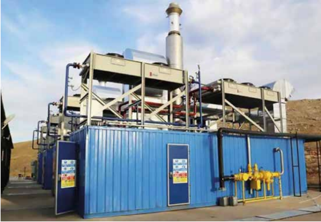
Eyyübiye Katı Atık Depolama Tesisi
