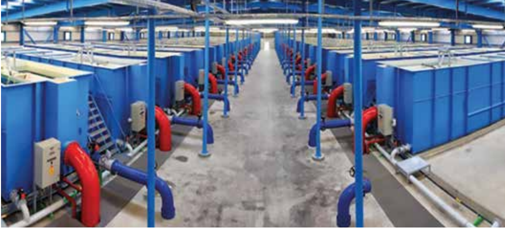
Hızırlyas İçmesuyu Arıtma Tesisi
