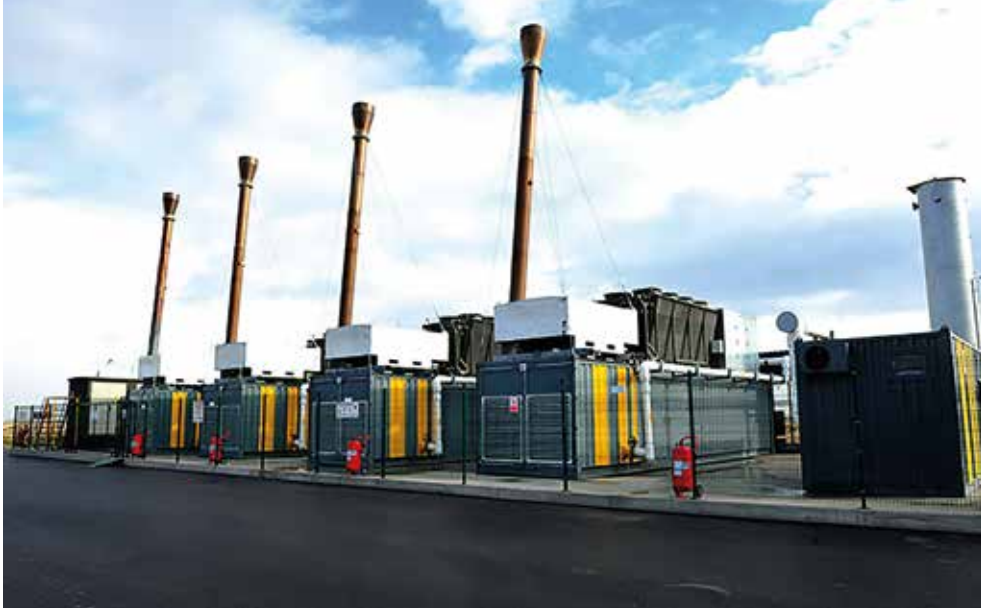
Katı Atık Tesislerinde Elektrik Üretimi
