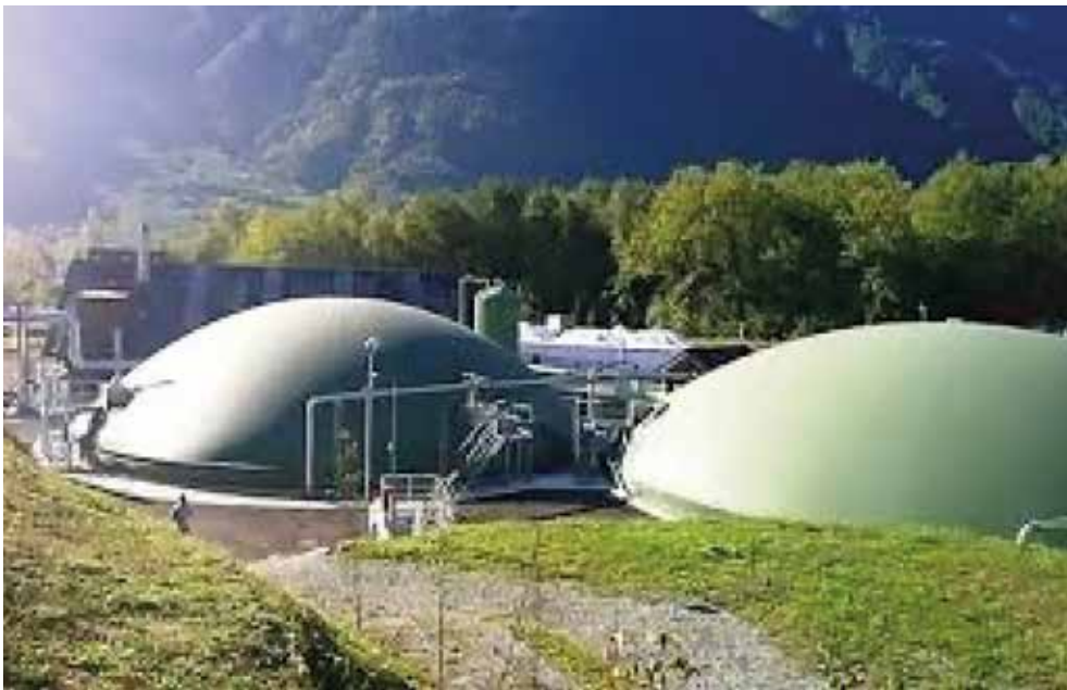
Kömürcüoda Biyometanizasyon Tesisi
