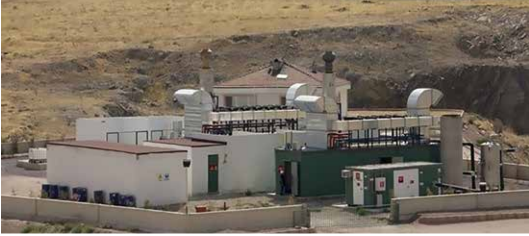
Kayseri Katı Atık Düzenli Depolama Tesisi Metan Gazı Elektrik Üretim Birimi
