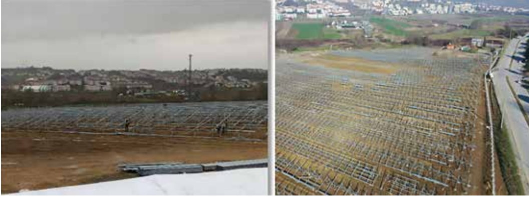
Adapazarı İlçesi, Karaman Atık Su Arıtma Tesisi, Güneş Panelleri
