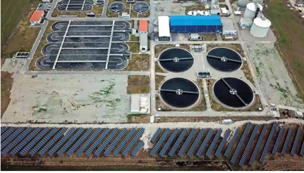
Merkez Atıksu Arıtma Tesisine Kurulan Güneş Panelleri
