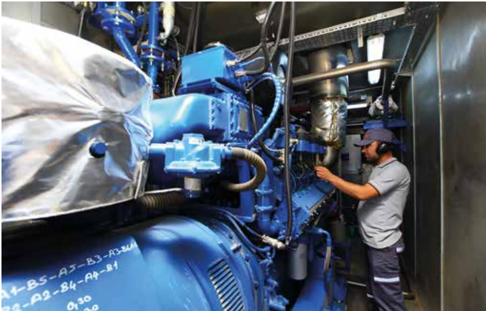
Denizli Katı Atık Bertaraf Tesisi Biyogaz Üretim Birimi
