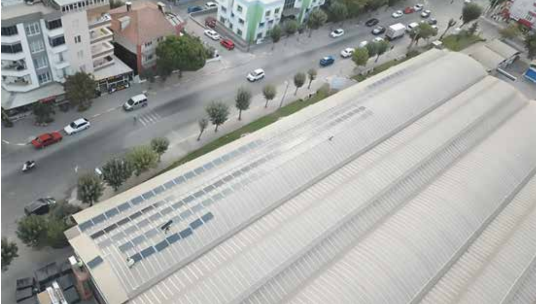
Karizma Kapalı Pazar Yeri Çatı GES
