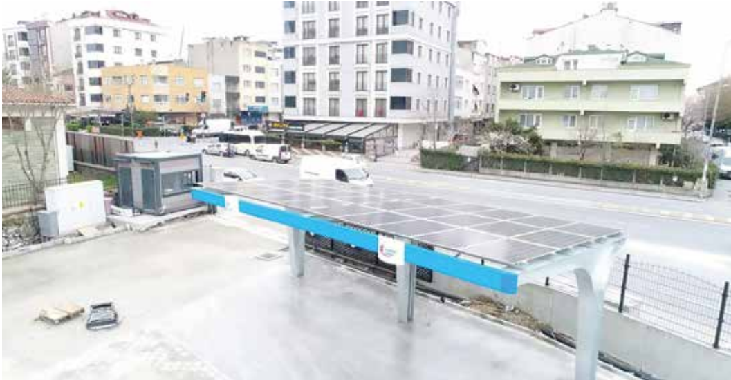
Bayrampaşa Yerleşkesi Otoparkı Güneş Enerjisi Santrali
