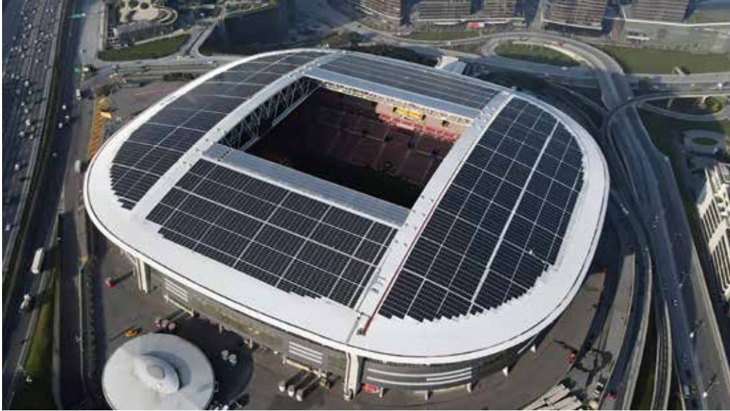
Nef Stadyumu Çatı Güneş Enerjisi Santrali
