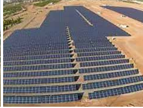
Hacıyusuflar Güneş Santrali
