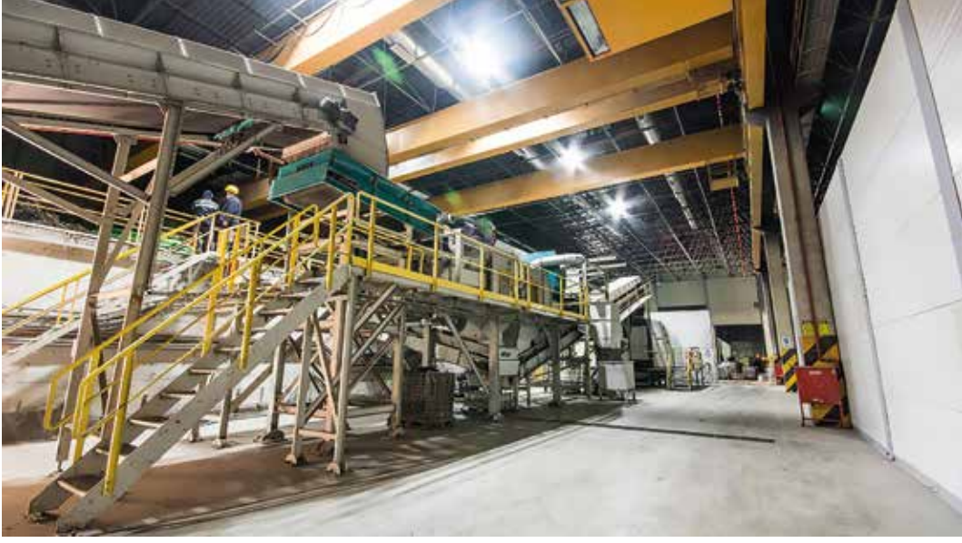
Çorlu Karatepe Entegre Katı Atık Tesisi Ayrıştırma Üniteleri
