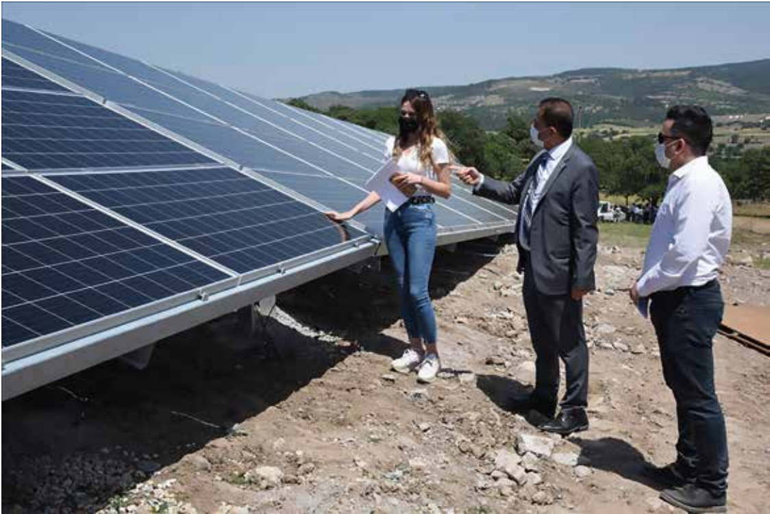
Güneş Enerjisi Santrali, Yunusemre İlçesi, Seyitli Mahallesi
