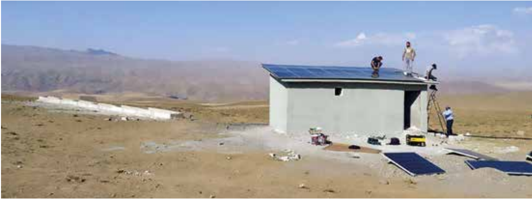
Güneş Enerjisi ile Çalışan Hayvan Sulama Terfi Merkezi
